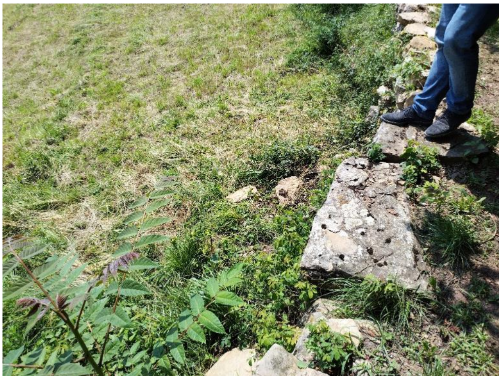
FIGURA 1 - ESEMPIO DI TRATTO DI CANALETTA ORMAI COMPLETAMENTE ABBANDONATO E INEFFICIENTE
