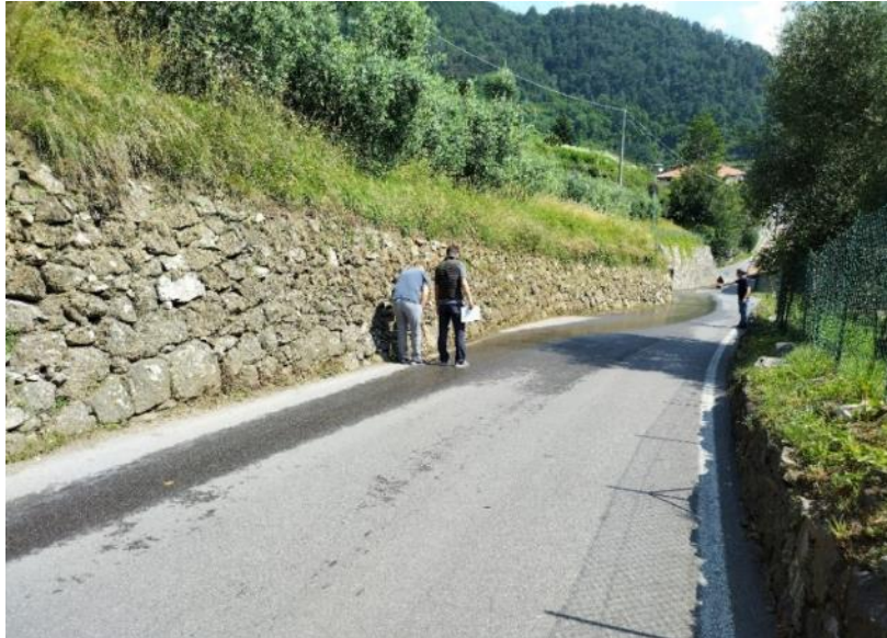
FIGURA 10 – VENUTE D'ACQUA IN LOCALITÀ BOSSOLETTI
